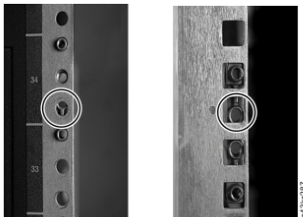
Figura 36. Ubicaciones de conector incorrectas
